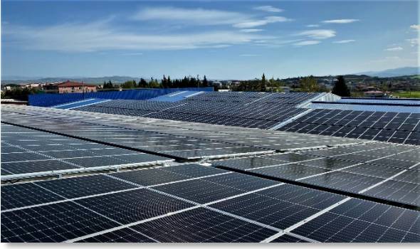
7.94 MWp – Kipaş Denim / Kahramanmaraş EPC Taahhüt
