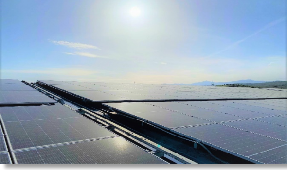
0.9 MWp Sarka Kağıt / Kahramanmaraş EPC Taahhüt
