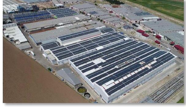
7,94 MWp - Kipaş Denim / Kahramanmaraş EPC Taahhüt
